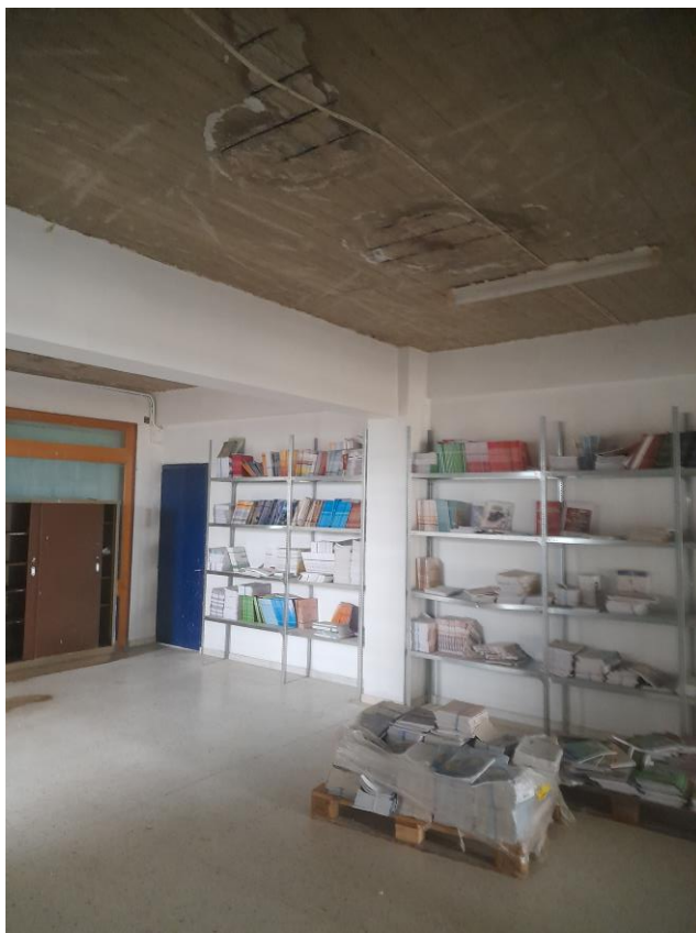
Κτίριο Β: υγρασίες και εκτεταμένη ενανθράκωση σκυροδέματος και διάβρωση οπλισμών στην πλάκα οροφής ισογείου
