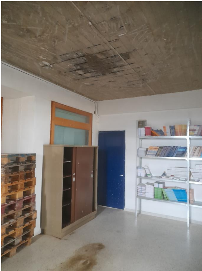
Κτίριο Β: υγρασίες και εκτεταμένη ενανθράκωση σκυροδέματος και διάβρωση οπλισμών στην πλάκα οροφής ισογείου
