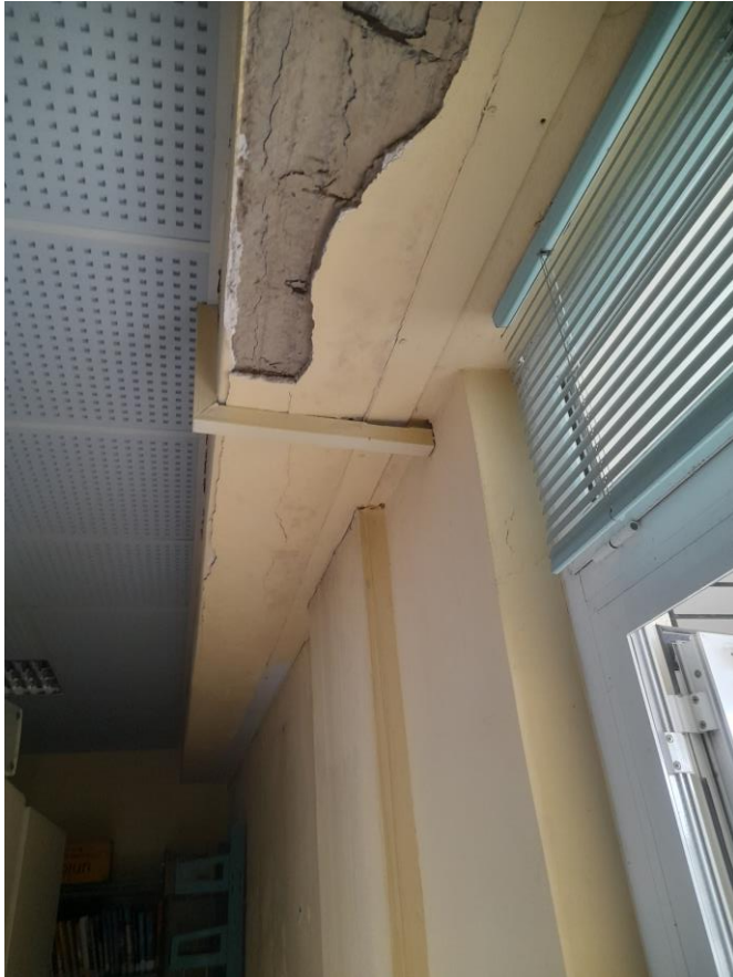
Κτίριο Γ: Ισόγειο, υγρασίες στον αρμό και υγρασίες και έντονη διάβρωση οπλισμών στην δοκό
