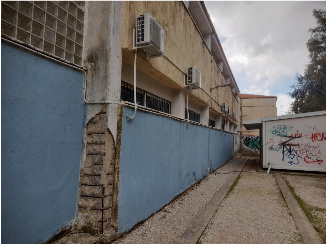
Κτίριο Δ βόρεια όψη, εκτεταμένη ενανθράκωση σκυροδέματος και διάβρωση σιδηρού οπλισμού υποστυλωμάτων, αποφλοιώσεις σκυροδέματος
