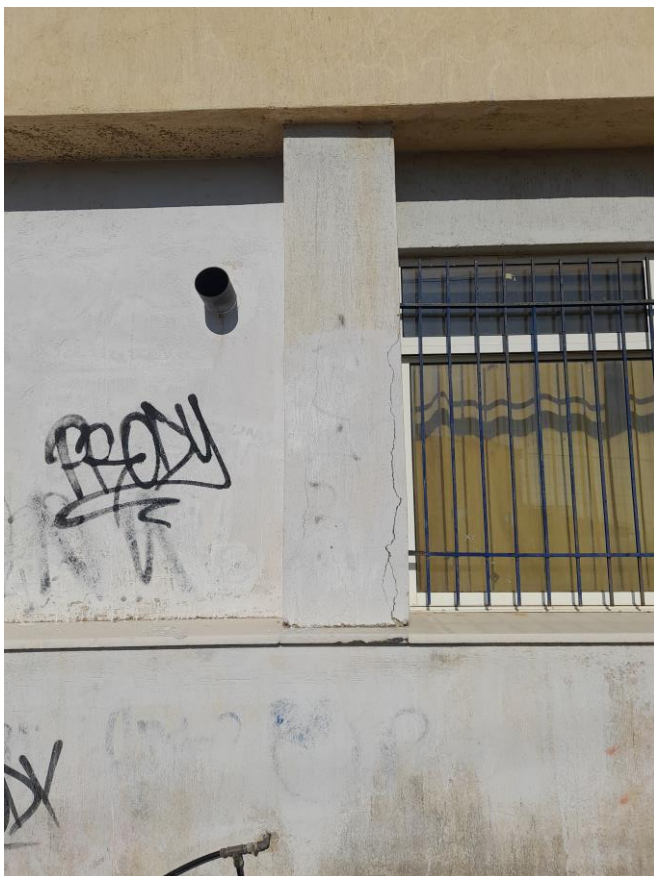
εκτεταμένη ενανθράκωση σκυροδέματος και διάβρωση σιδηρού σπλισμού υποστυλωμάτων
