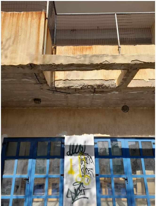
εκτεταμένη ενανθράκωση σκυροδέματος και διάβρωση σιδηρού οπλισμού
