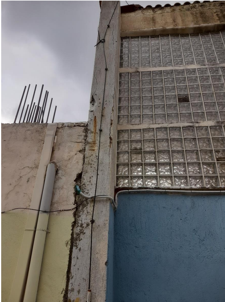
Κτίριο Δ βόρεια όψη στον αρμό επαφής με το κτίριο Ε, εκτεταμένη ενανθράκωση σκυροδέματος και διάβρωση σιδηρού οπλισμού υποστυλωμάτων, αποφλοιώσεις σκυροδέματος.
