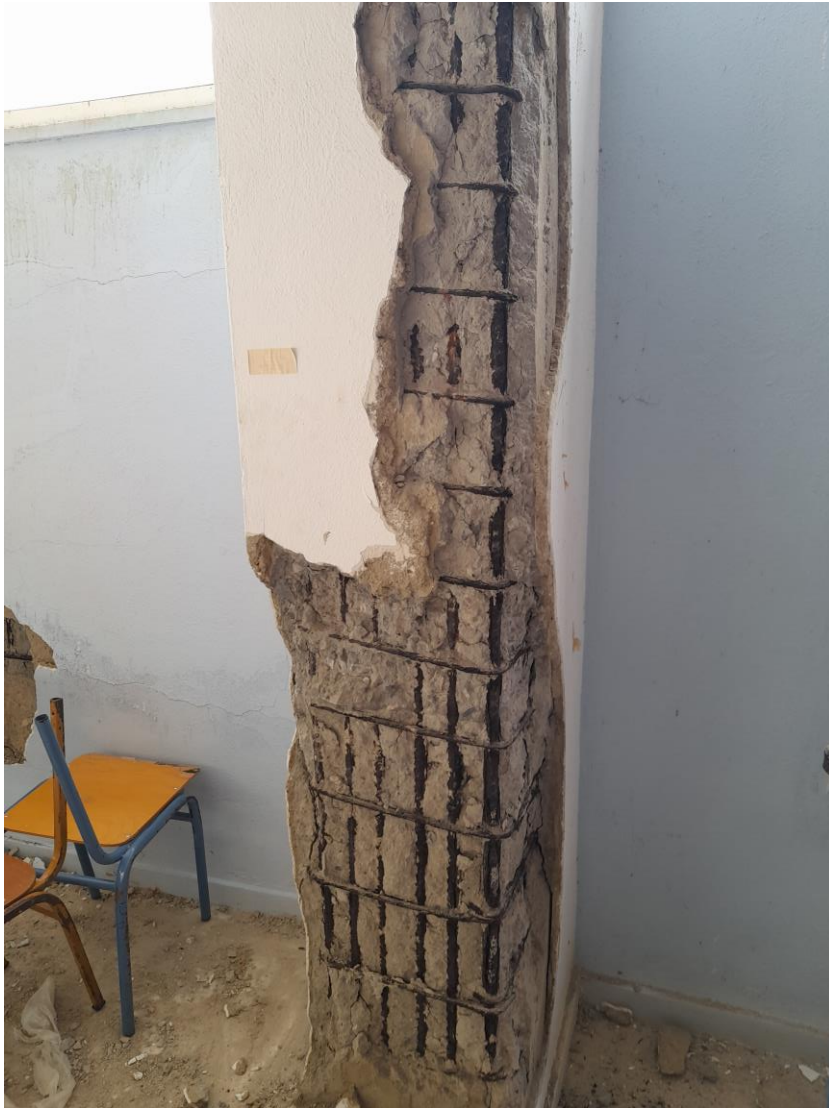
Κτίριο Α έντονη ενανθράκωση σκυροδέματος και διάβρωση οπλισμών, στα υποστυλώματα, αποφλοιώσεις σκυροδέματος.
