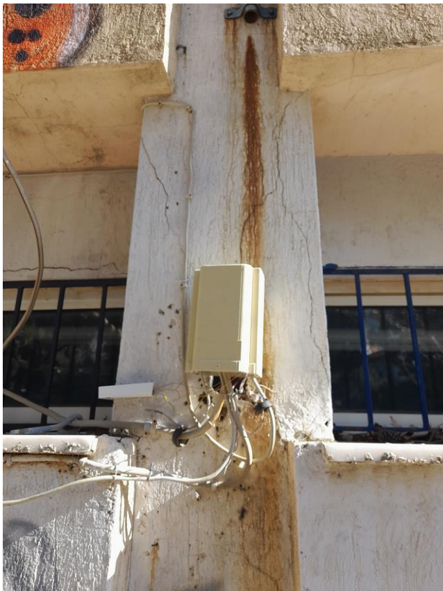
εκτεταμένη ενανθράκωση σκυροδέματος και διάβρωση σιδηρού οπλισμού υποστυλωμάτων
